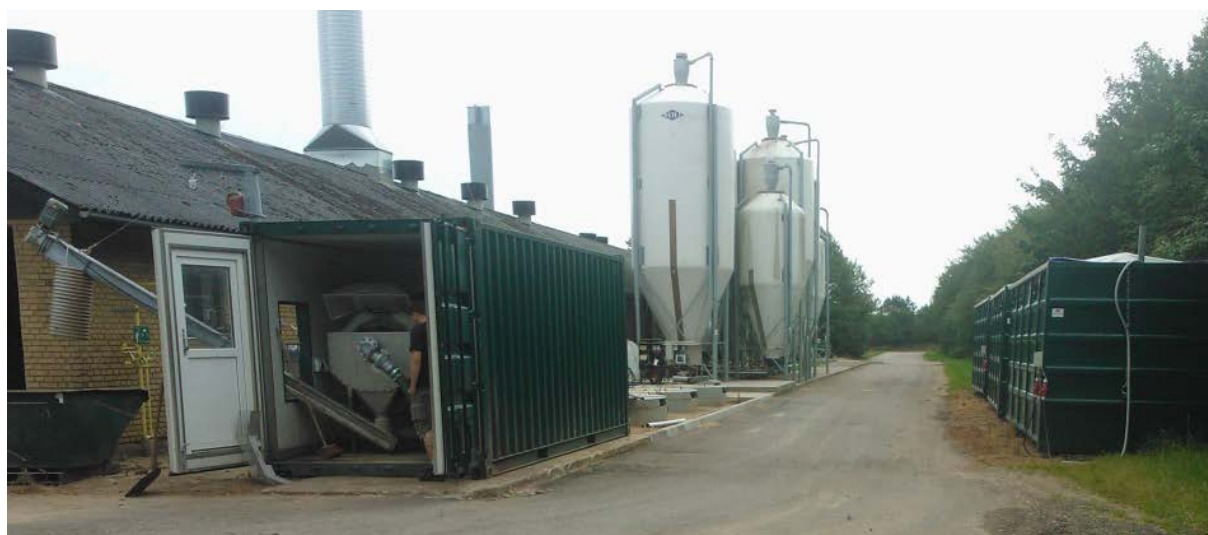
Figur 2. Gyllebehandlingsanlæg ved Forsøgsstation Grønhøj. Containeren forrest til venstre indeholdt afvandingstrømlen til separation af gyllen. Væsken fra separation blev ledt til en procestank, hvor pH blev justeret til pH 5,5 inden returpumpning til stalden. Fiberfraktionen blev opsamlet i containeren helt til venstre i billedet.
